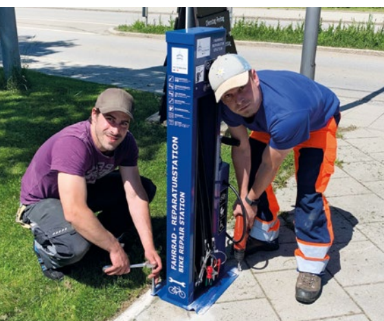
Neue Fahrradreparatur- und Luftpumpenstationen
